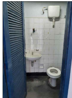
5 FOTO DO VESTIÁRIO FUNCIONÁRIOS VESTIÁRIO COM BACIA SANITÁRIA E LAVATÓRIO EM LOUÇA BRANCA, COM TORNEIRAS E ACESSÓRIOS, AS PEÇAS SE APRESENTAM COM POUCOS DESGASTES. AS PAREDES COM REVESTIMENTO CERÂMICO APRESENTAM MANCHAS E TRINCAS. PISO EM GRANILITE NA COR PRETA APRESENTA PONTOS DESGASTADOS.
