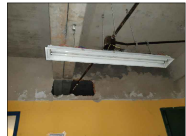
5 6 FOTOS DO HALL O AMBIENTE SE ENCONTRA SEM FORRO, COM FURAS NA PARTE SUPERIOR DA PAREDE QUE SE ENCONTRA O BEBEDOURO EM ALVENARIA. A LUMINÁRIA SE ENCONTRA INSTALADA. AS PAREDES APRESENTAM PINTURA COM SUJIDADES E MANCHAS. E O TRECHO DE PAREDE COM O BEBEDOURO EM ALVENARIA APRESENTA REVESTIMENTO CERÂMICO ATÉ 1,50m. OS BEBEDOUROS ESTÃO SEM AS TORNEIRAS.
