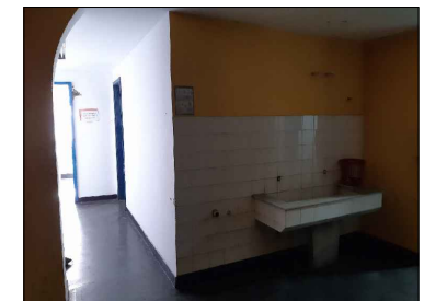
4 FOTO DO HALL O REBAIXAMENTO EM FORRO E A LUMINÁRIA SE ENCONTRAM INSTALADAS E COM BOM ESTADO. A PAREDE EM QUE SE ENCONTRA O BEBEDOURO APRESENTA REVESTIMENTO COM TRINCAS.
