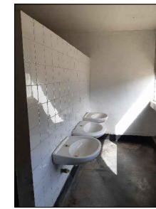
5 FOTO DOS LAVATÓRIOS O BANHEIRO APRESENTA 3 PONTOS DE LAVATÓRIO. EXISTEM 3 LAVATÓRIOS SEM COLUNA EM LOUÇA BRANCA INSTALADOS, SEM TORNEIRAS.
