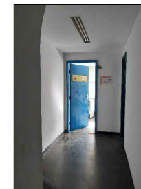
3 FOTO DA CIRCULAÇÃO O REBAIXAMENTO EM FORRO E A LUMINÁRIA SE ENCONTRAM INSTALADAS E COM BOM ESTADO.
