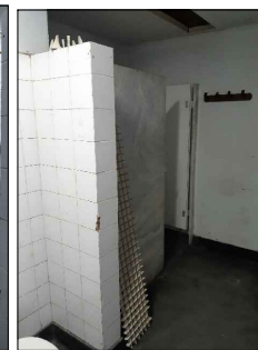
7 FOTO DO VESTIÁRIO FUNCIONÁRIOS TRECHO ONDE SE LOCALIZA O BOX APRESENTA REVESTIMENTO CERÂMICO COM TRINCAS.
