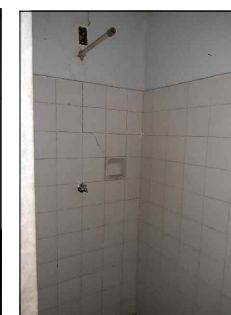
8 BOX DO VESTIÁRIO FUNCIONÁRIOS TRECHO ONDE SE LOCALIZA O BOX APRESENTA REVESTIMENTO CERÂMICO COM TRINCAS. LOCAL SEM CHUVEIRO INSTALADO.
