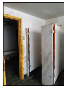
2 FOTO DAS CABINES SANITÁRIAS CABINES COM DIVISÓRIAS EM MÁRMORE BRANCO E PORTAS COM LAMINADO NA COR BRANCA. AS CABINES APRESENTAM DESGASTE E MANCHAS EM ALGUNS PONTOS E AS PORTAS SE ENCONTRAM EMPENADAS E SEM FECHO.
