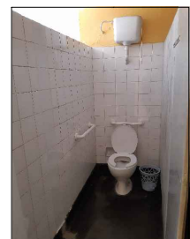
9 VISÃO DA CABINE SANITÁRIA AMPLIADA NESSE BANHEIRO HOVE A AMPLIAÇÃO DA CABINE SANITÁRIA PARA MELHORAR O ACESSO. MAS A CABINE NÃO SE ENCONTRA DENTRO DAS NORMAS VIGENTES DE ACESSIBILIDADE.
