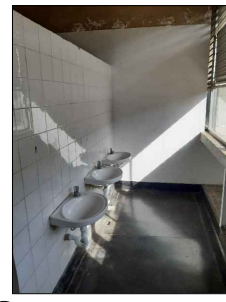
1 FOTO DOS LAVATÓRIOS O BANHEIRO APRESENTA 3 PONTOS COM LAVATÓRIOS INSTALADOS. NO MODELO SEM COLUNA EM LOUÇA BRANCA. AS TORNEIRAS SE ENCONTRAM INSTALADAS.
