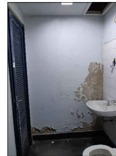
6 FOTO DO VESTIÁRIO FUNCIONÁRIOS VESTIÁRIO APRESENTA PINTURA COM DESCOLORIMENTO. O FORRO APRESENTA FURROS E APENAS UMA LUMINÁRIA SE ENCONTRA INSTALADA.
