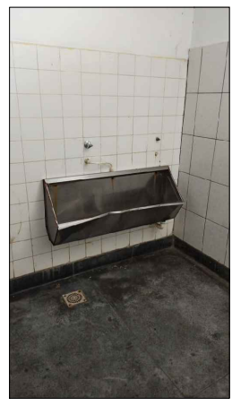
FOTO DO MICTÓRIO EM INOX MICTÓRIO EM INOX INSTALADO MAS TRECHOS AMASSADOS E COM PRESENÇA DE FERRUGEM.
