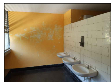
10 FOTO DOS LAVATÓRIOS O BANHEIRO APRESENTA 3 PONTOS COM LAVATÓRIOS INSTALADOS. NO MODELO SEM COLUNA EM LOUÇA BRANCA. AS TORNEIRAS SE ENCONTRAM INSTALADAS. A PAREDE APRESENTA PINTURA COM MANCHAS E DESGASTE.
