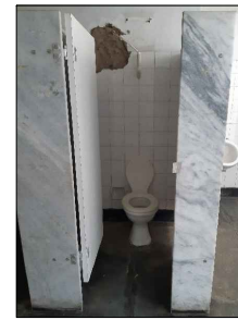
3 FOTO DAS CABINES SANITÁRIAS CABINES COM DIVISÓRIAS EM MÁRMORE BRANCO E PORTAS COM LAMINADO NA COR BRANCA. AS CABINES APRESENTAM DESGASTE E MANCHAS EM ALGUNS PONTOS E AS PORTAS SE ENCONTRAM EMPENADAS E SEM FECHO.
