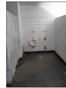
4 FOTO DOS MICTÓRIOS TRECHO COM ESPAÇO PARA INSTALAÇÃO DE 2 MICTÓRIOS, NO MOMENTO APENAS UMA UNIDADE EM LOUÇA BRANCA INSTALADA.
