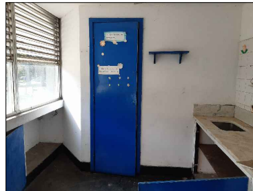
1 FOTO DA COPA COPA COM BANCADA EM MÁRMORE COM MANCHAS E DESGASTE EM ALGUNS TRECHOS, APRESENTA CUBA EM INOX NO LOCAL, MAS A TORNEIRA E DEMAIS CONEXÕES NÃO ESTÃO INSTALADAS. A PINTURA DAS PAREDES APRESENTA SUJIDADES.
