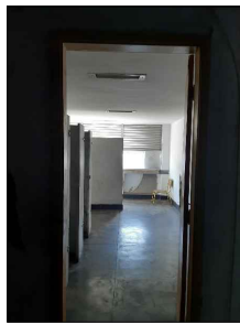
1 VISÃO GERAL DO BANHEIRO AMBIENTE COM FORRO E LUMINÁRIAS PRESERVADAS. PISO EM GRANILITE PRETO DESGASTADO E PAREDES COM TRECHOS COM DESCOLAMENTO DA PINTURA.
