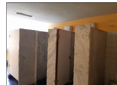
8 FOTO DAS CABINES SANITÁRIAS CABINES COM DIVISÓRIAS EM MÁRMORE BRANCO E PORTAS COM LAMINADO NA COR BRANCA. AS CABINES APRESENTAM DESGASTE, TRECHOS QUEBRADOS E MANCHAS EM ALGUNS PONTOS E AS PORTAS SE ENCONTRAM EMPENADAS E SEM FECHO.
