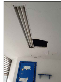
2 FOTO DA COPA O REBAIXAMENTO EM FORRO APRESENTA FURO E A PINTURA POSSUI DESCOLORIMENTO EM ALGUNS TRECHOS. A LUMINÁRIA SE ENCONTRA INSTALADA.
