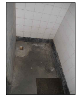
9 BOX DO VESTIÁRIO FUNCIONÁRIOS PISO DO BOX COM DESGASTE E MANCHAS E SEM RALO INSTALADO.
